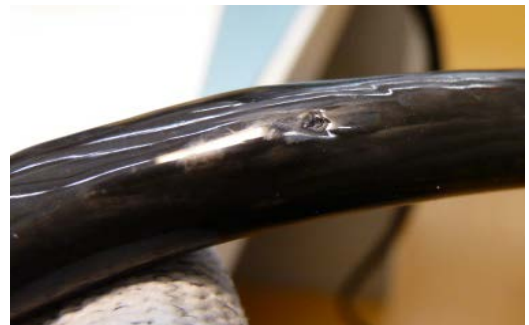
Figura 8: Cavo Motore danneggiato
