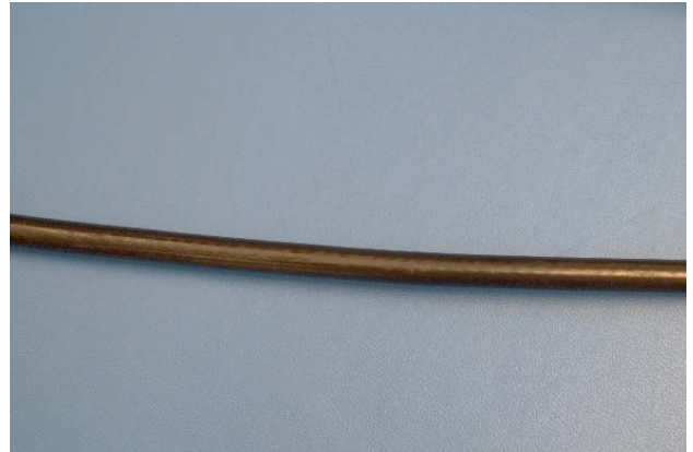
Figura 6: Cavo Motore intatto e non danneggiato
