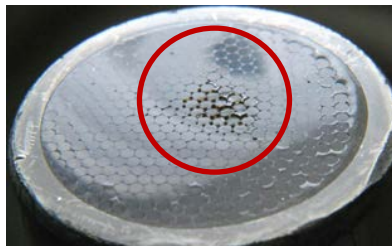
Figura 2: Cuscinetto quasi deteriorato I sintomi sono presenti. Potrebbe essere necessario sostituire il
