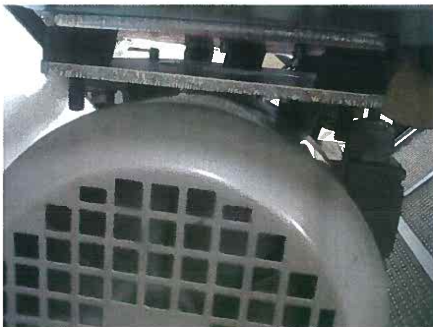
Fig. 1: Esempio di ammortizzatore di gomma deteriorato su piastra di assemblaggio.
